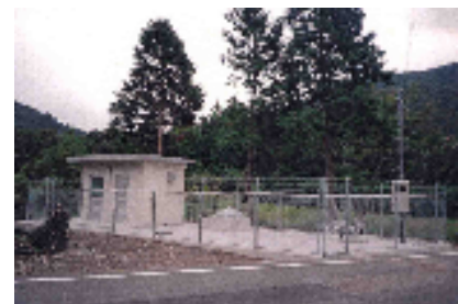
【写真：名留川取水ポンプ】
