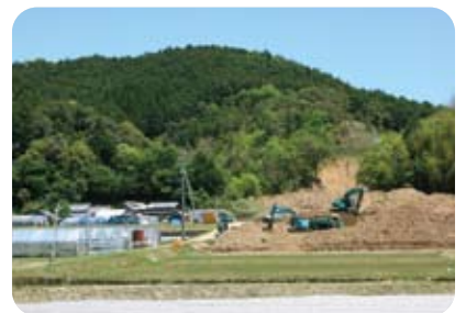
工事中の山：勝賀野城があったとされる土居山は、昨年の台風の際に大きく崩落し、現在復旧作業が続く
